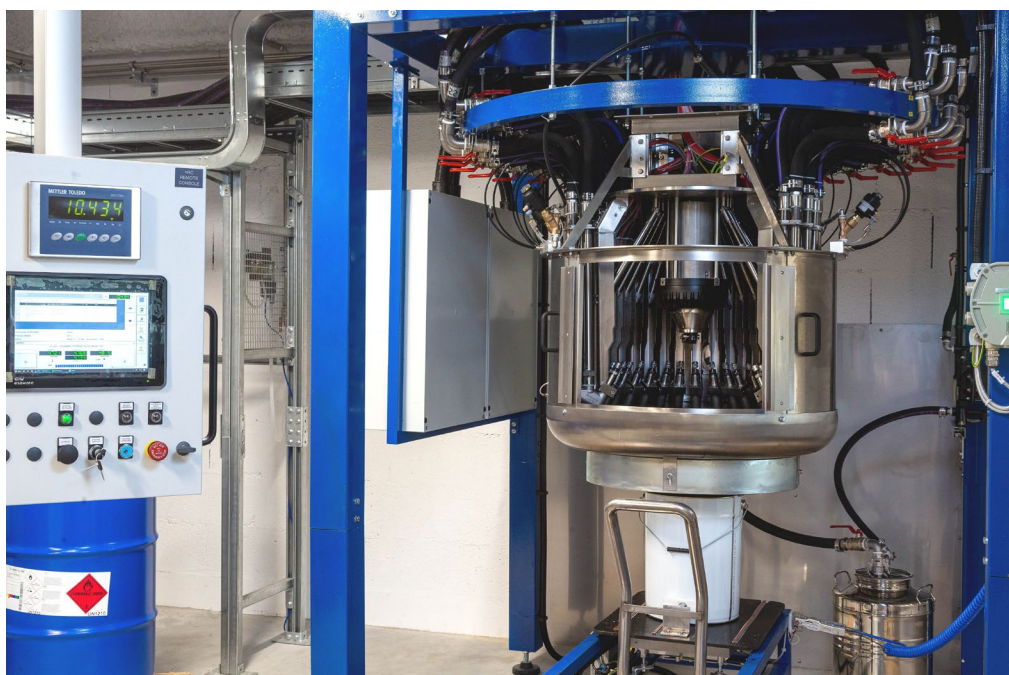
L'une des deux stations de fabrication des encres
